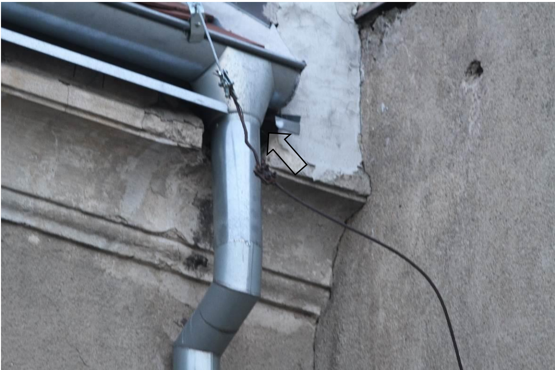
Zdj. 44 Potencjalne siedlisko rozrodu ptaków i nietoperzy
