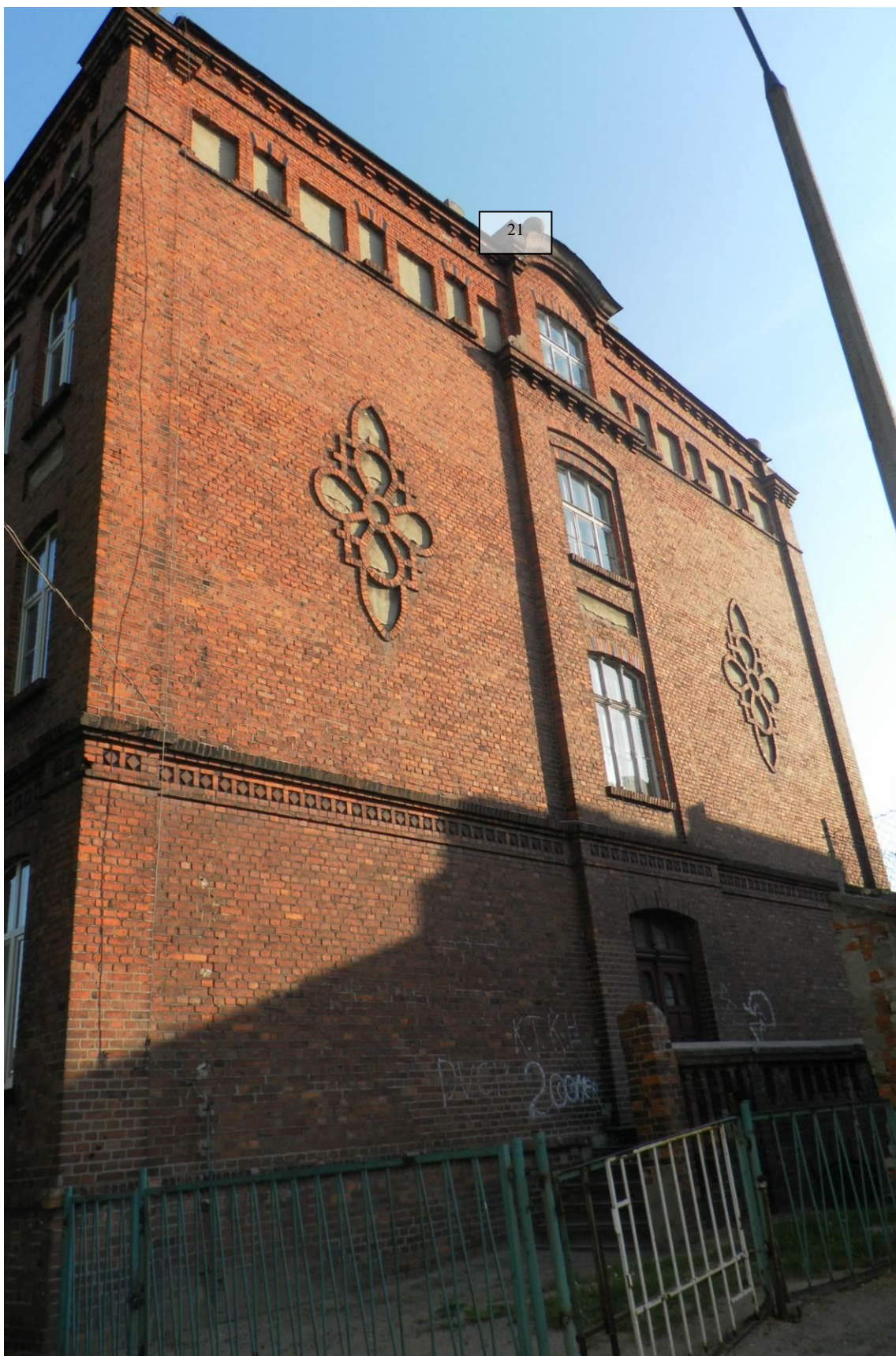
Zdj. 20 Budynek Szkoły Podstawowej nr 2 od strony południowo-wschodniej z numerem zdjęcia ukazującym zbliżenie na potencjalne siedlisko
