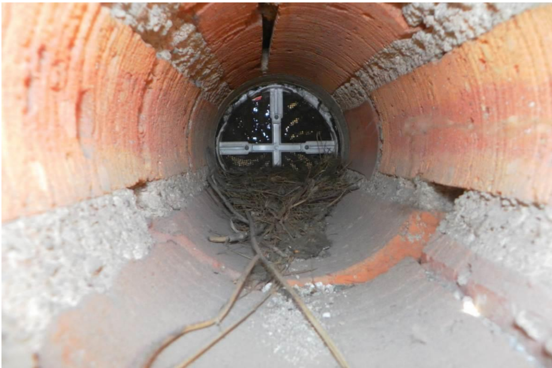
Zdj. 13 Gniazdo w otworze wentylacyjnym w budynku Krytej Pływalni w Chełmży
