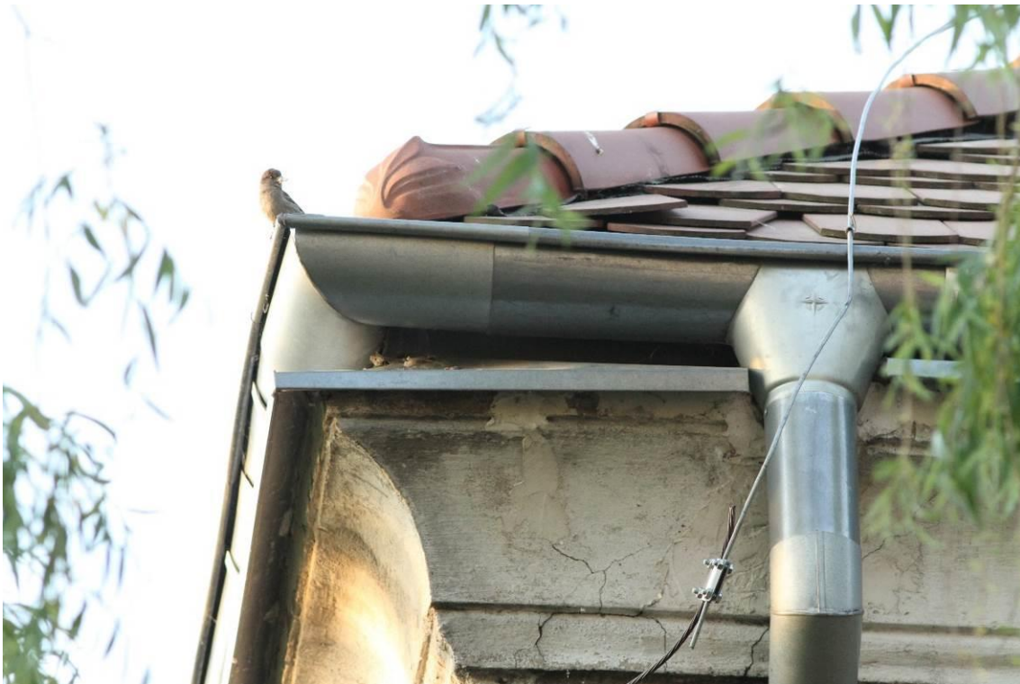
Zdj. 9 Stanowisko lęgowe wróbla w przestrzeni między rynną a dachem w budynku Szkoły Podstawowej nr 3 w Chełmży
