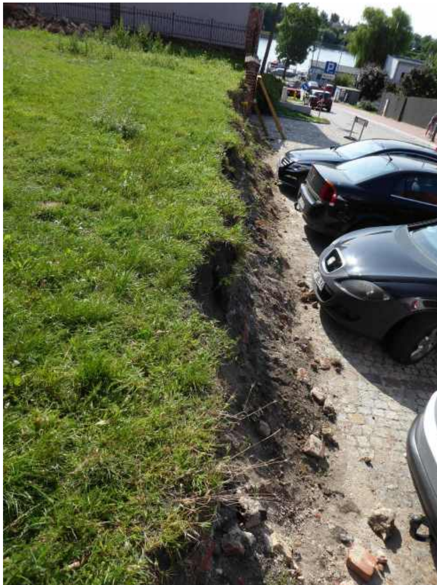
Fot.3. Odcinek zawalonego muru – wzdłuż ul. Sądowej
