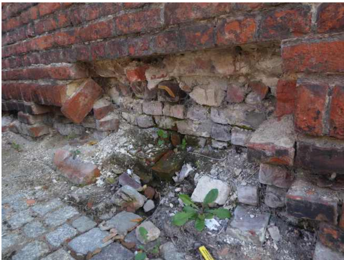
Fot.4. Uszkodzenie cokołu muru przy rurce drenarskiej – widok od ul. Sądowej
