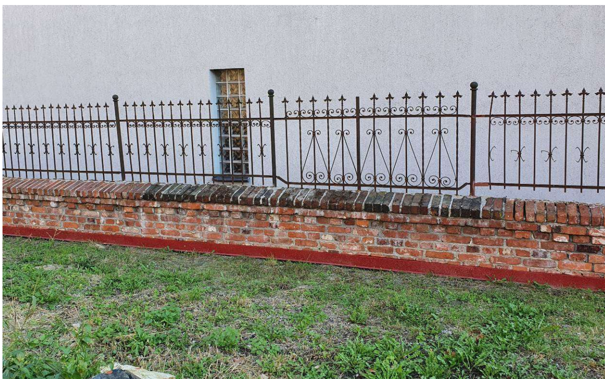
Fot.19. Chełmża, parafia pw. św. Mikołaja Bpa. Fragment południowego odcinka ogrodzenia po niedawnych pracach remontowych. Na zdjęciu widoczne lokalne wysolenia oraz listwa dociskowa folii kubekowej.
