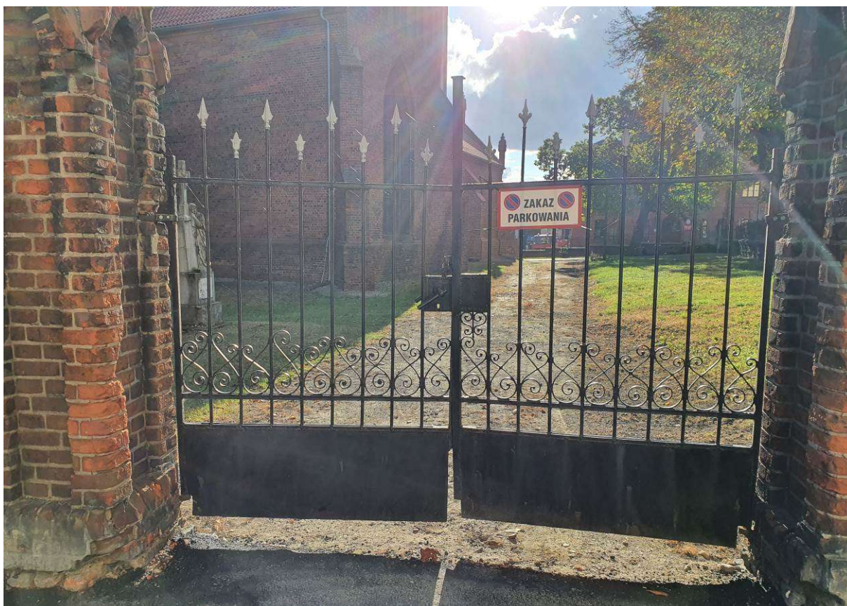
Fot.30. Chełmża, parafia pw. św. Mikołaja Bpa. Brama wjazdowa od strony wschodniej. Na zdjęciu widoczne uszkodzenia słupów bramy, ubytki cegieł, spoin, itd.
