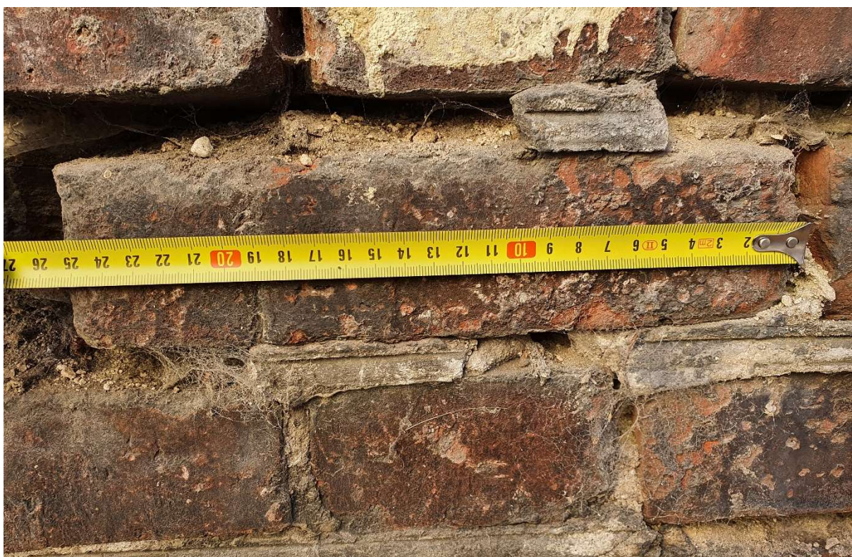
Fot.7. Chełmża, parafia pw. św. Mikołaja Bpa. Widok ogrodzenia terenu przykościelnego od strony ulicy. Mikołaja Kopernika. Na zdjęciu widoczne głębokie ubytki spoin.
