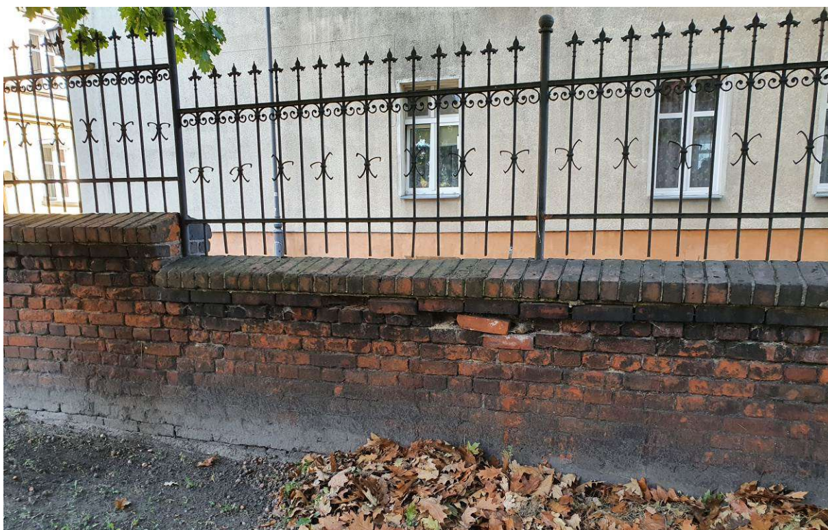
Fot.29. Chełmża, parafia pw. św. Mikołaja Bpa. Przęśla wschodniej strony ogrodzenia w widoku od strony terenu przykościelnego. Lokalnie czytelne są zniszczenia spowodowane przez sole rozpuszczalne w wodzie.
