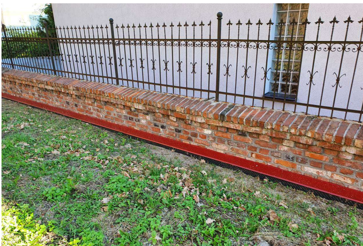
Fot.20. Chełmża, parafia pw. św. Mikołaja Bpa. Fragment południowego odcinka ogrodzenia po niedawnych pracach remontowych. Na zdjęciu widoczne lokalne wysolenia oraz listwa dociskowa folii kubekowej.
