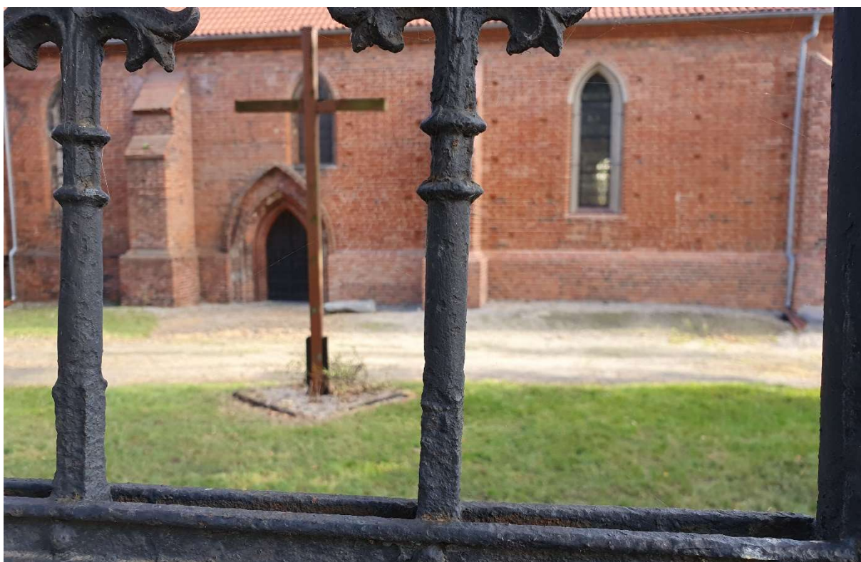
Fot.33. Chełmża, parafia pw. św. Mikołaja Bpa. Stan zachowania ażuru. Metal jest głęboko skorodowany a przekroje profili pomniejszone. Na zdjęciu fragment dekoracji wykonanej w technikach odlewniczych, łączonej z elementami kutymi.
