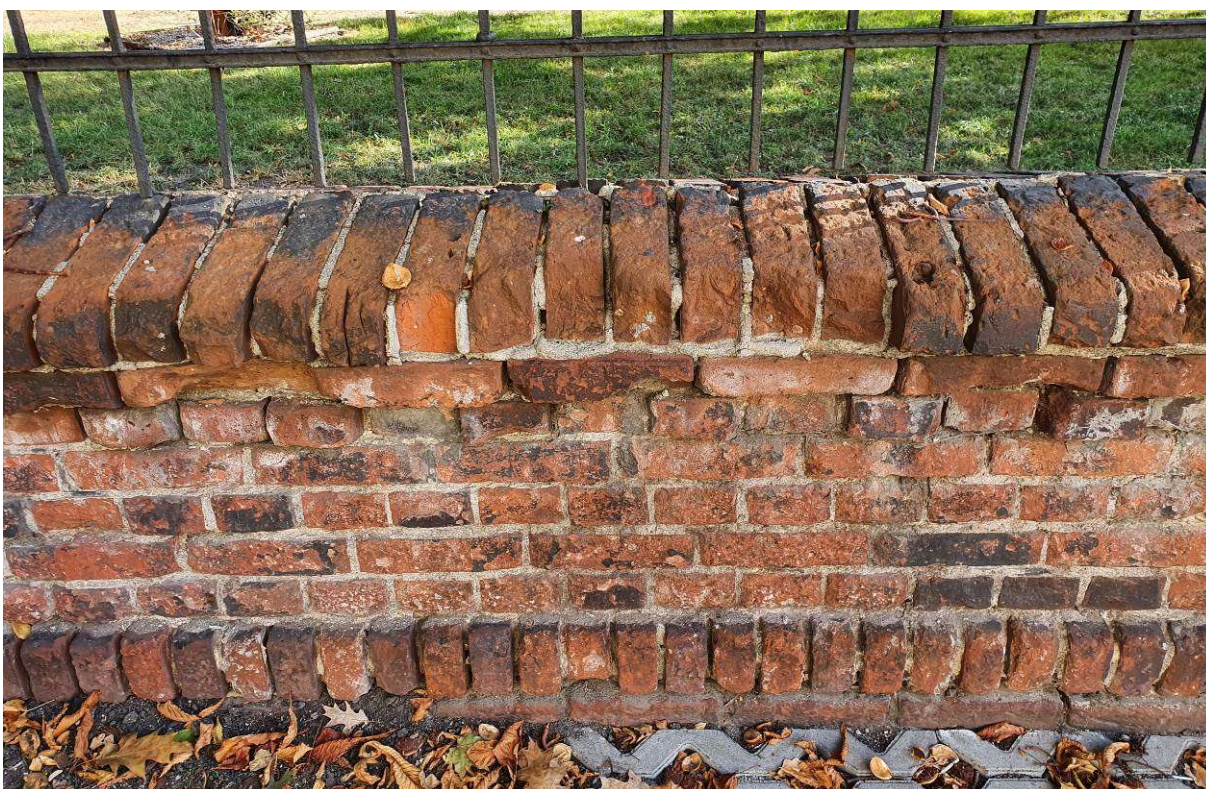
Fot.5. Chełmża, parafia pw. św. Mikołaja Bpa. Widok ogrodzenia terenu przykościelnego od strony ulicy Mikołaja Kopernika. Wątek ceglany jest silnie zniszczony o licu złuszczonej z widocznymi śladami wysoleń i dezintegracji granularnej.
