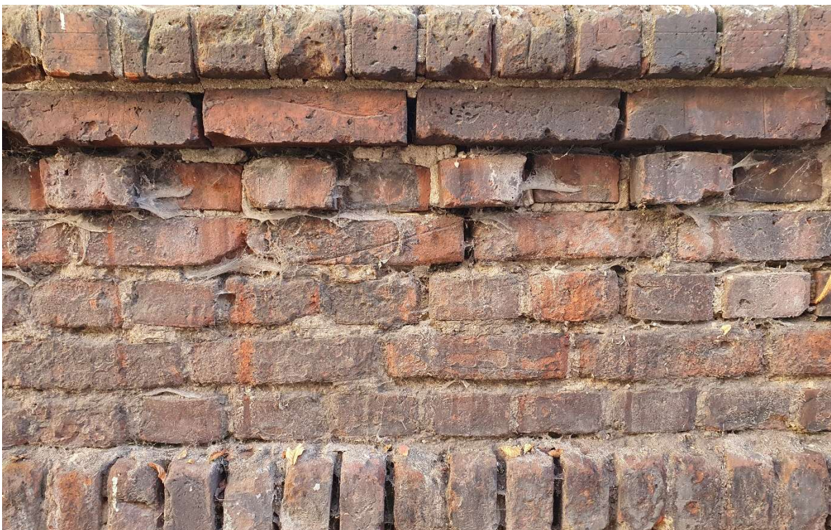
Fot.6. Chełmża, parafia pw. św. Mikołaja Bpa. Widok ogrodzenia terenu przykościelnego od strony ulicy Mikołaja Kopernika. Wątek ceglany jest silnie zniszczony o licu złuszczonej z widocznymi śladami wysoleń i dezintegracji granularnej.
