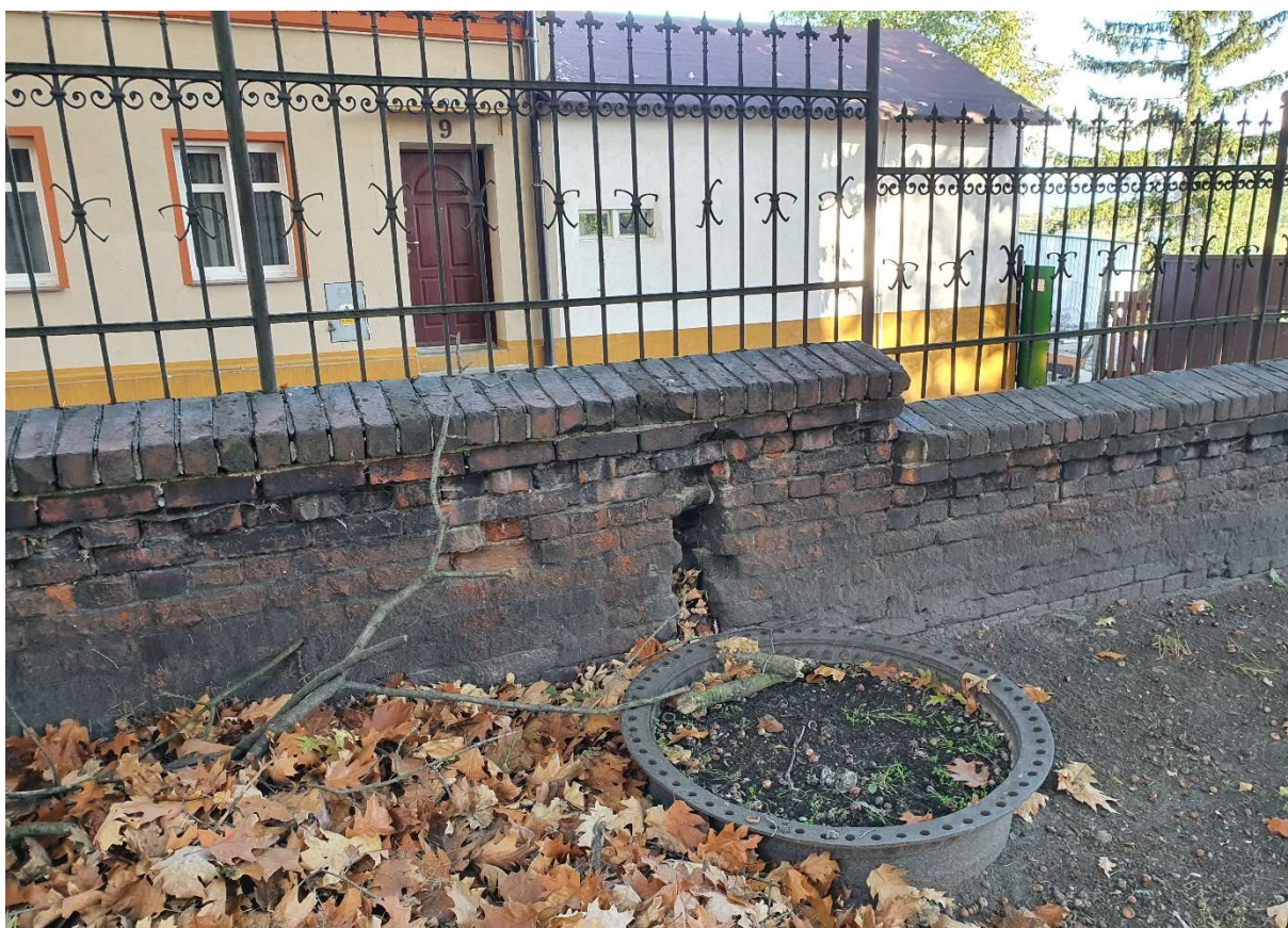
Fot.28. Chełmża, parafia pw. św. Mikołaja Bpa. Przęśła wschodniej strony ogrodzenia w widoku od strony terenu przykościelnego. Widoczne głębokie ubytki spoin i materiału ceramicznego.
