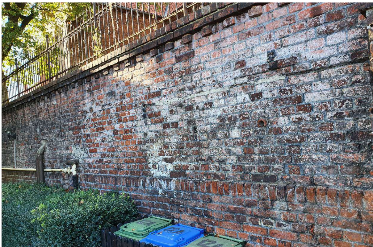
Fot.23. Chełmża, parafia pw. św. Mikołaja Bpa. Przęśla południowe w widoku od strony działki 144/2. Na zdjęciu widoczne obszerne zasolenie muru.
