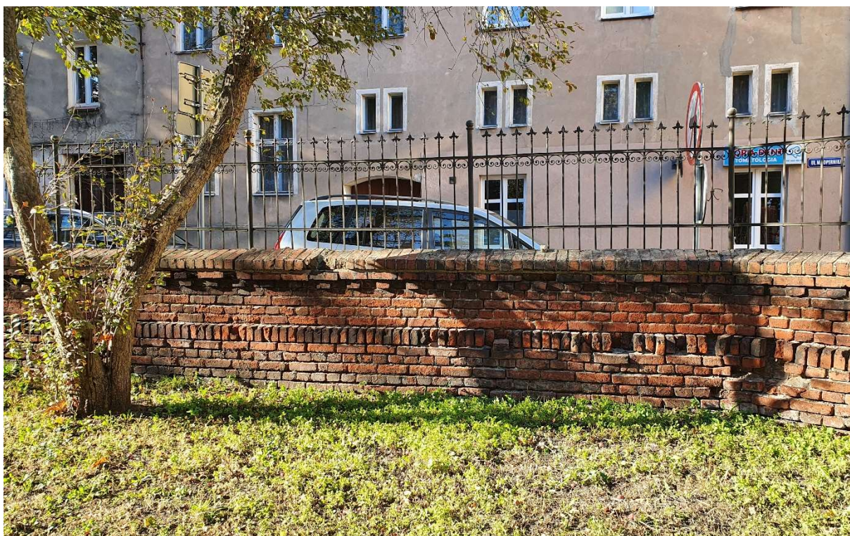
Fot.8. Chełmża, parafia pw. św. Mikołaja Bpa. Północne przęsło ogrodzenia w widoku od strony terenu przykościelnego. Wątek ceglany jest silnie zniszczony o licu złuszczone z widocznymi śladami wysoleń i dezintegracji granularnej.
