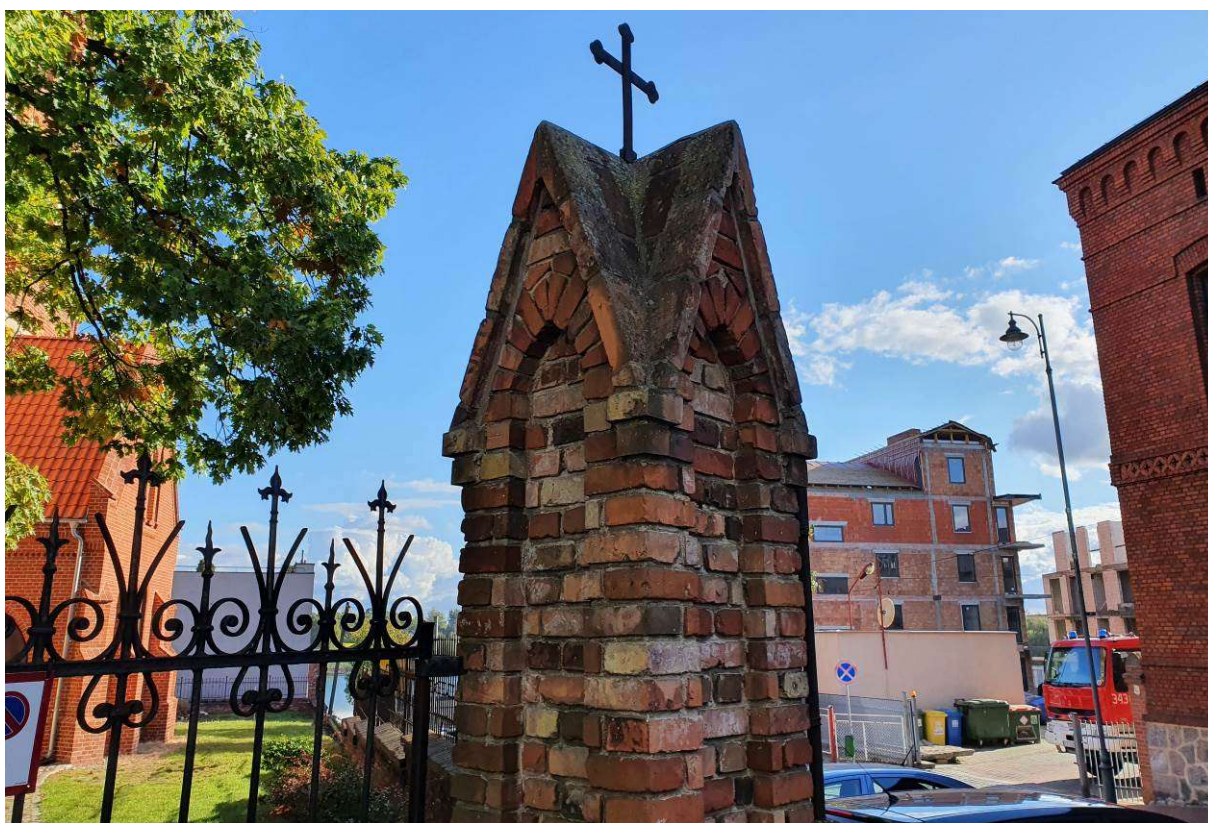
Fot.13. Chełmża, parafia pw. św. Mikołaja Bpa. Prawy słupek bramy od ulicy Mikołaja Kopernika. Na zdjęciu widoczne przemurowania wykonane z cegły o dość przypadkowej kolorystyce.
