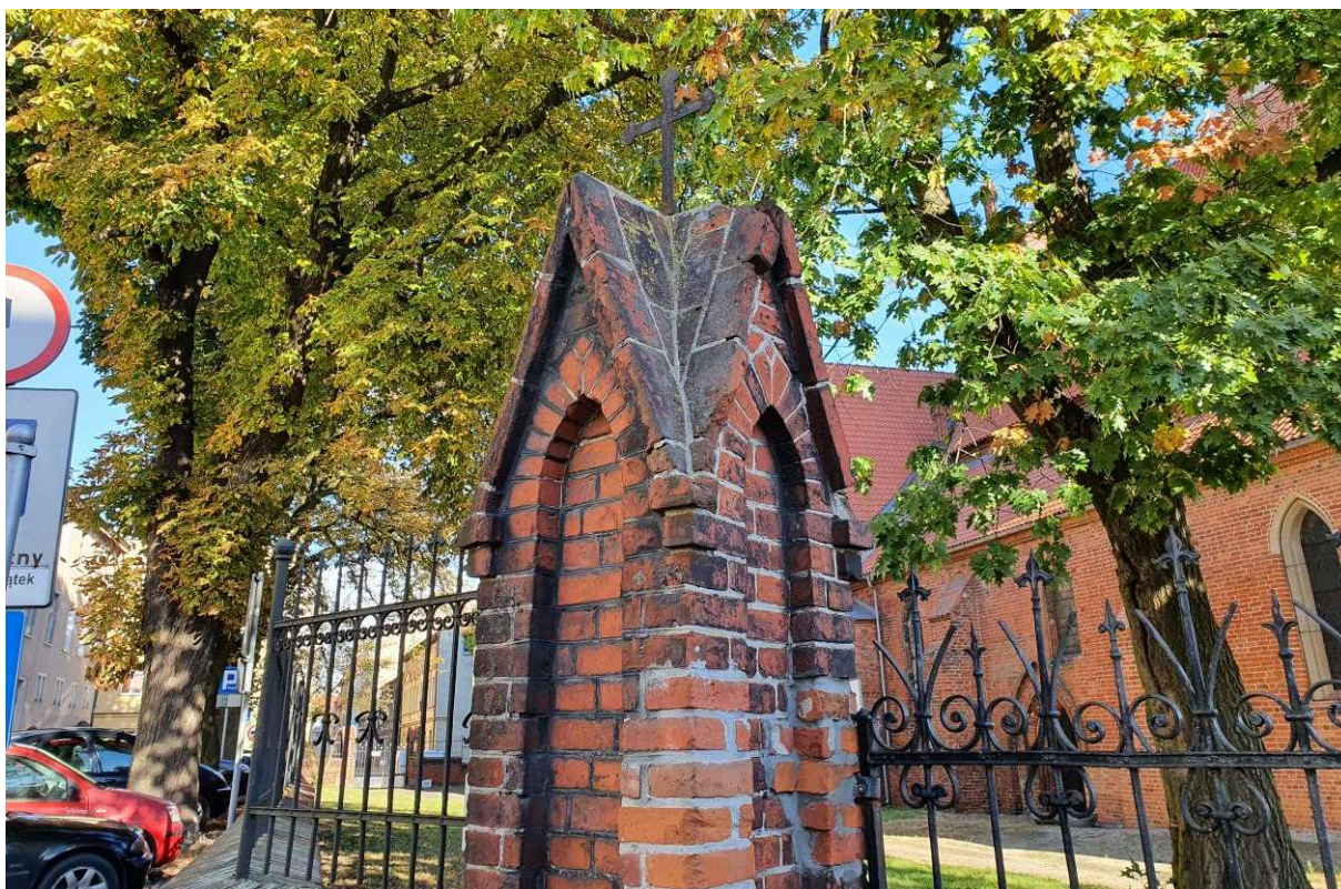
Fot.11. Chełmża, parafia pw. św. Mikołaja Bpa. Lewy słupek bramy od ulicy Mikołaja Kopernika. Na zdjęciu widoczne przemurowania wyspoinowane jasnoszarą zaprawą cementową.
